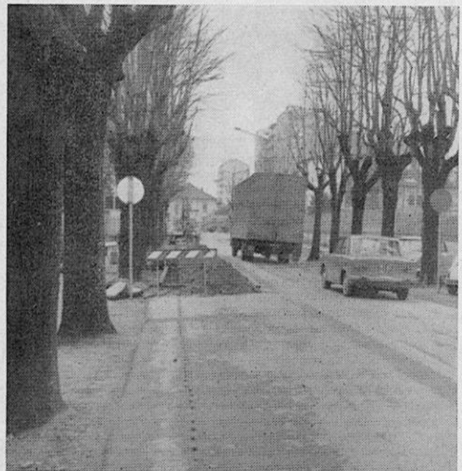
La «festa degli alberi» è coincisa quest'anno con un delicato omaggio reso ai tigli di Viale Predabissi: a pochi centimetri dalla base del tronco è stata scavata una trincea per la posa di una conduttura. Quale giovamento trarranno le povere piante, da un lavoro che poteva benissimo essere fatto diversamente, è facile immaginarlo.
